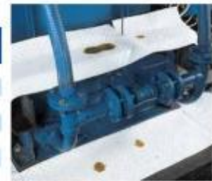
Вокруг машинного оборудования для сбора протечек
